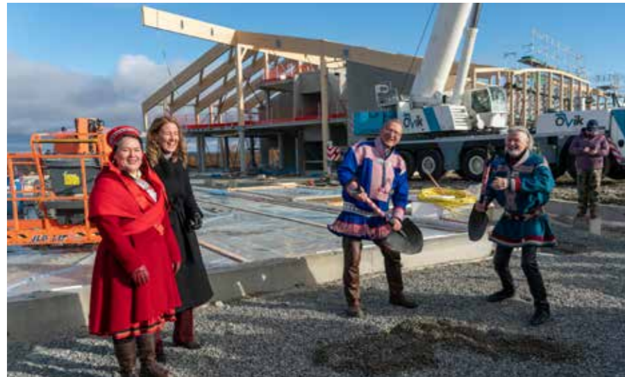
Sametingspresident Silje K. Muotka (t.v.) og kunnskapsminister Tonje Brenna la ned grunnsteinen for det nye samlokaliserte kultur- og skolebygget i Kautokeino. (Fotograf: Aslak Mikal Mienna)
